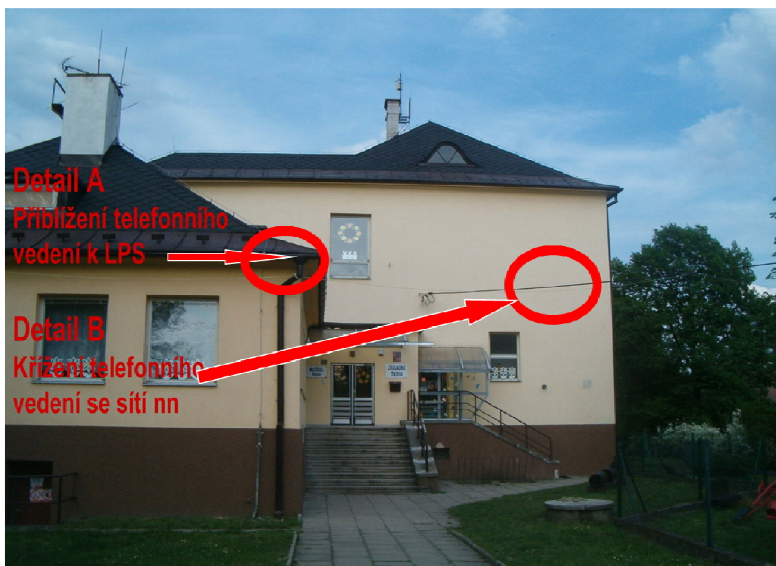
Obr. 7.1b – Nedostatečná vizuální kontrola revizního technika - nedodržení dostatečné vzdálenosti s
