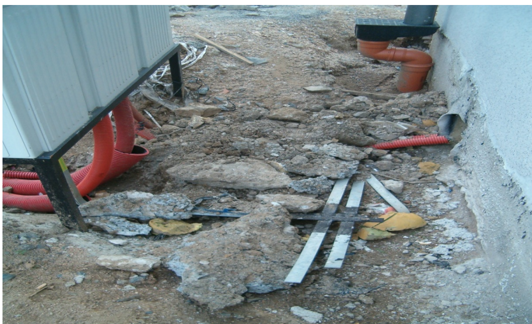
Obr. 6.5.1a – Nevhodné uložení strojeného zemniče
