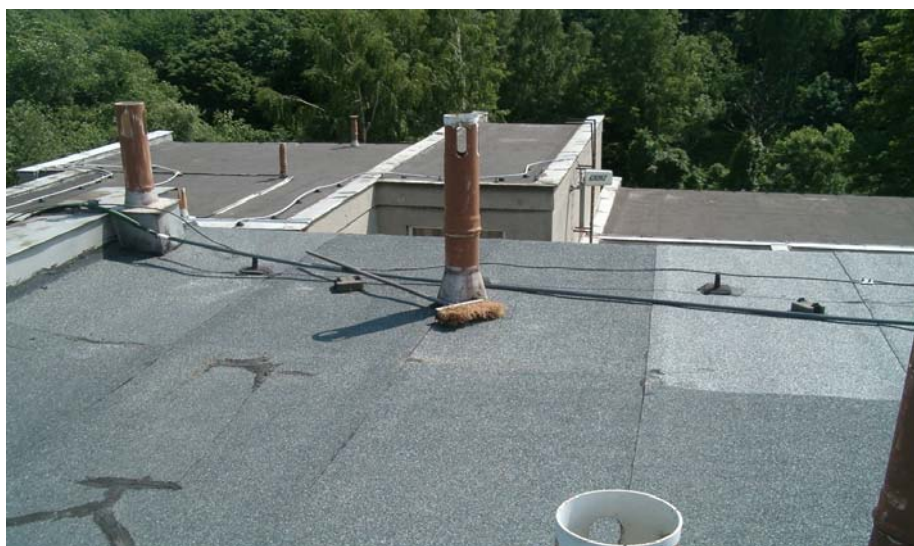
Obr. 7.1a – Nedostatečná vizuální kontrola revizního technika – hořlavé předměty na jímací soustavě
