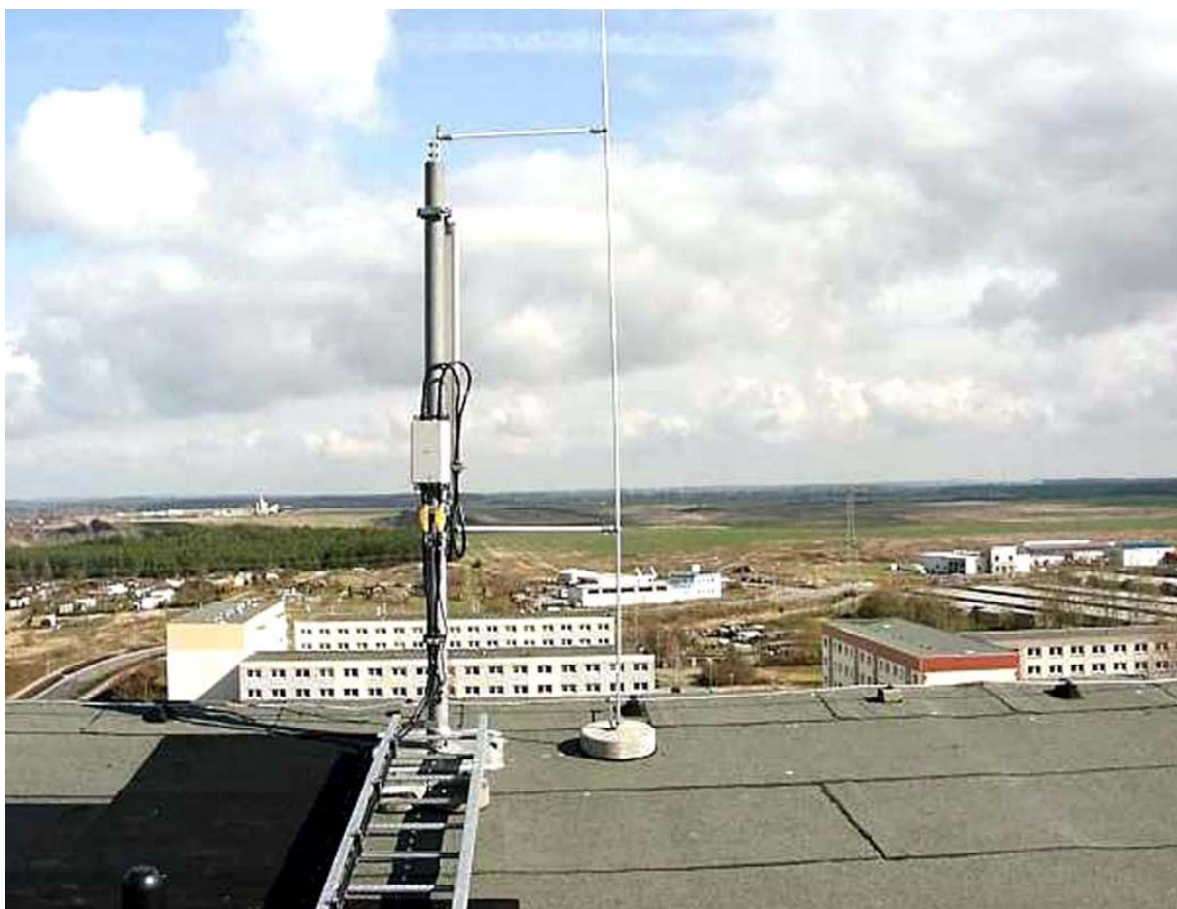
Obr. 7.4a – Stanice mobilních operátorů oddálený hromosvod s držákem DEHNiso
