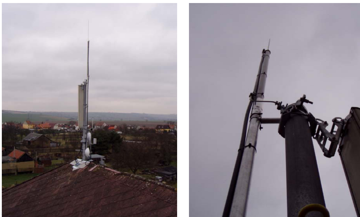
Obr. 7.4b – Stanice mobilních operátorů izolovaný hromosvod - vodič HVI
